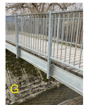
Mise en oeuvre d'une passerelle accessible aux PMR entre le parking 1 et la zone d'accueil de la chapelle
