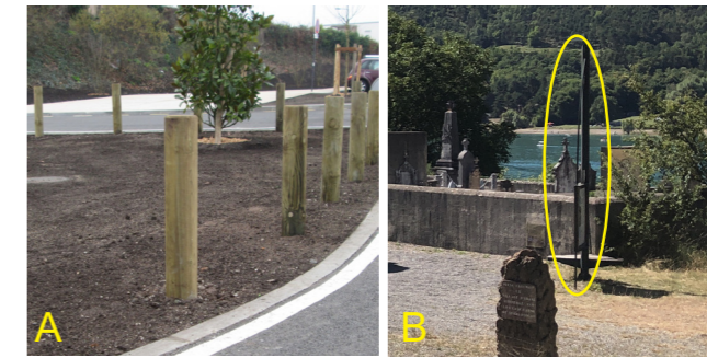
Mise en sécurité et organisation de la zone avec potelets bois Déplacement du panneau d'information existant
